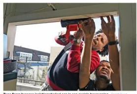
Twee fixers brengen isolatiemateriaal aan in een sociale huurwoning. Sjoelissa Duijzen / de Volkskrant
