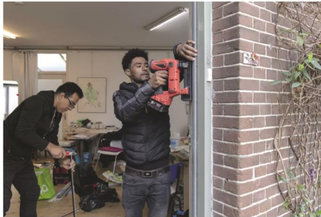
Een medewerker van de FIXbrigade isoleert de buitendeur met tochtstrips. Het initiatief van duurzaamheidscentrum Jungle Amsterdam biedt mensen de mogelijkheid om met simpele oplossingen gratis of tegen een geringe vergoeding hun huis te laten isoleren en energie te besparen. Beeld ANP
